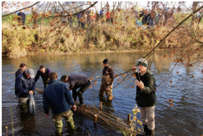
Den Kursteilnehmern des Gewässertags am gegenüberliegenden Ufer wurde der Bau einer Buhne demonstriert. | Foto: Alfred Peter
