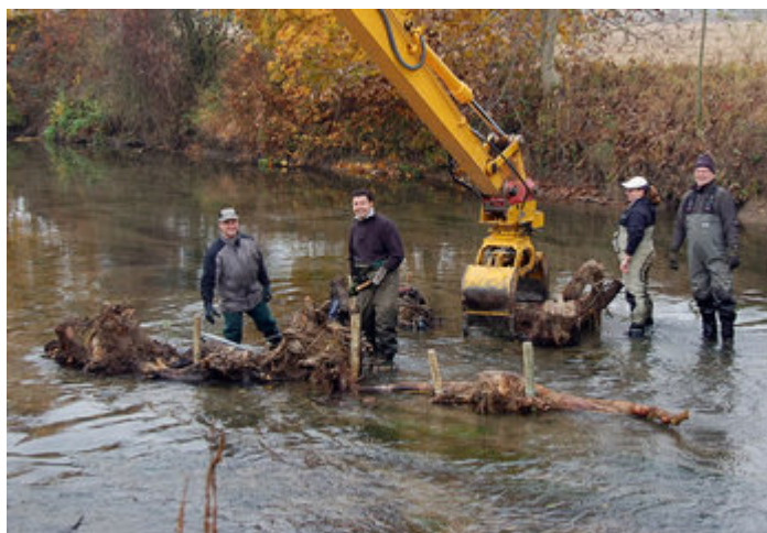
Strömunglenker wurden in die Alte Dreisam eingebaut. Beim Gewässertag am 11. November gibt es dazu Anschauungsobjekte. | Foto: Alfred Peter
